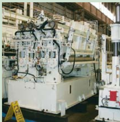
洗浄装置、ダウンカットシャー、コイル先端矯正
